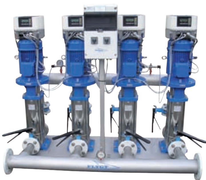
TFA-anläggning med Hydrovarstyrning som reglerar hastigheten för de fyra pumparna.
