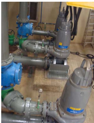
Flygts 3203-pumpar i pumpstationen vid Lake George.
